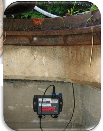
Exemple de téléalarme sur déversoir d'orage
