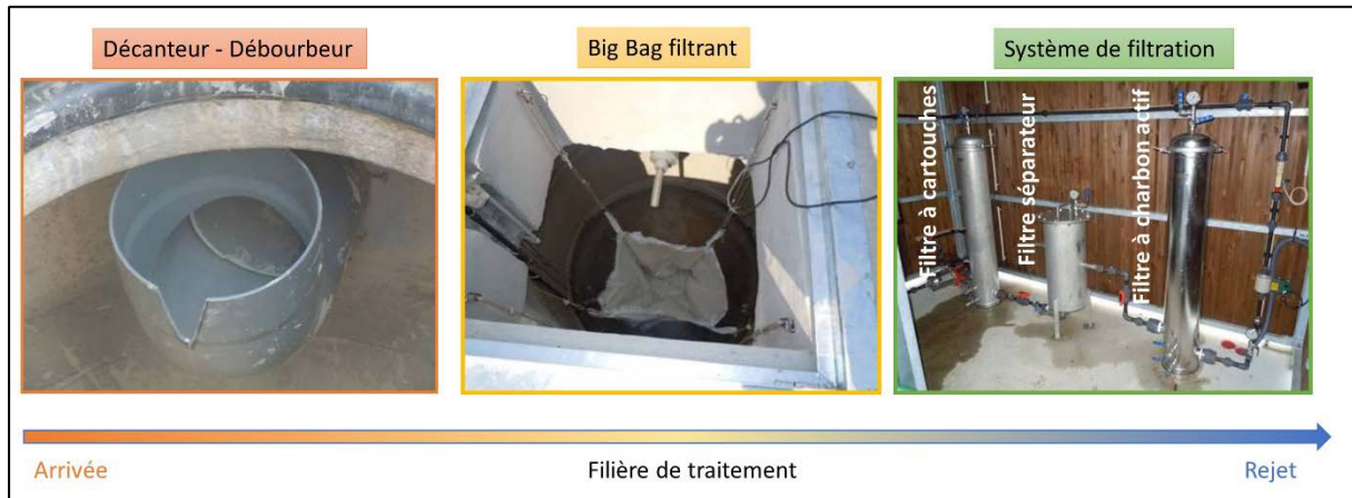
Figure 67 : Synthèse de la filière de traitement de la station de carénage du Port du Château à Brest (Kerlan Industrie, sd)
