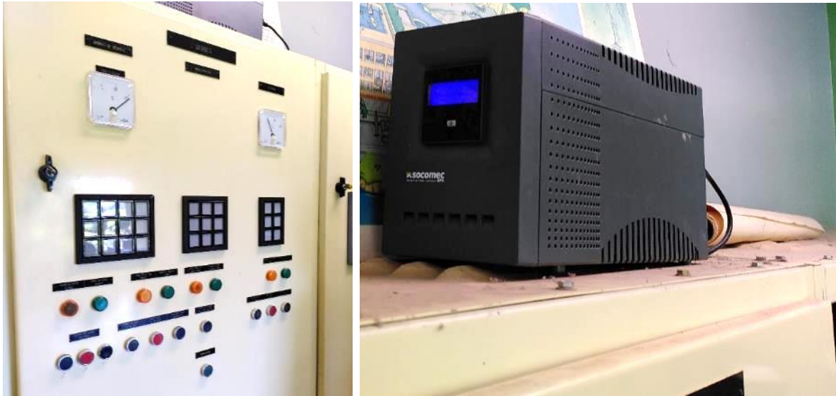
Figure 18 – Onduleur de courant posé sur l'armoire vanes
