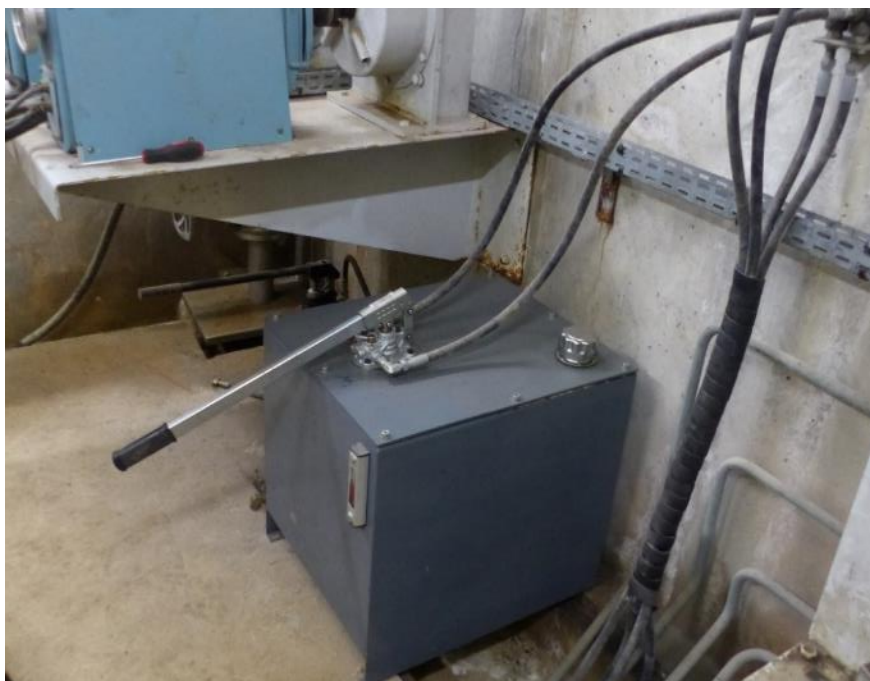
Figure 6 - Nouvelle pompe à main
