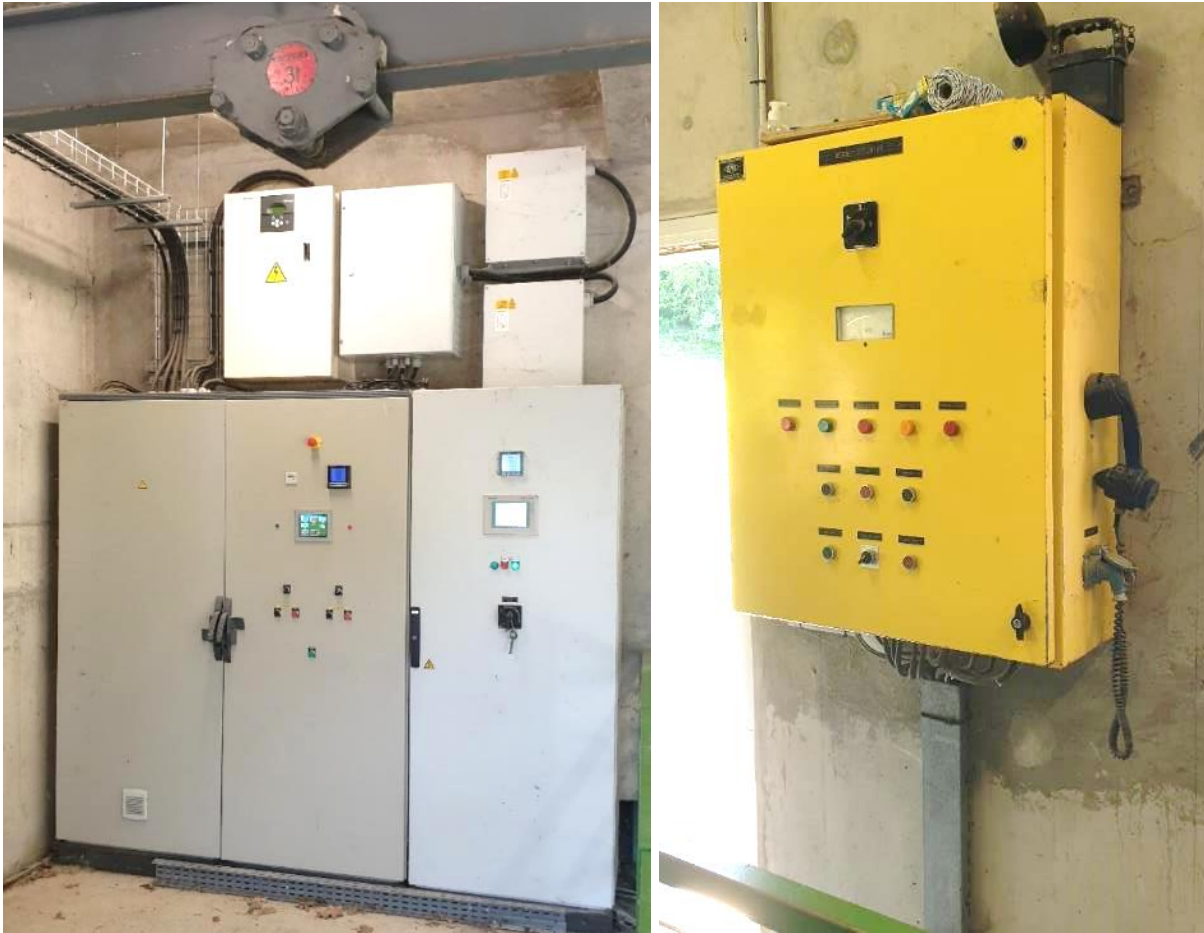
Figure 11 – Armoires de commande local des turbines de production (micro- et principale, inclus capacités de relevage CosPhi) et commande jet creux (jaune)
