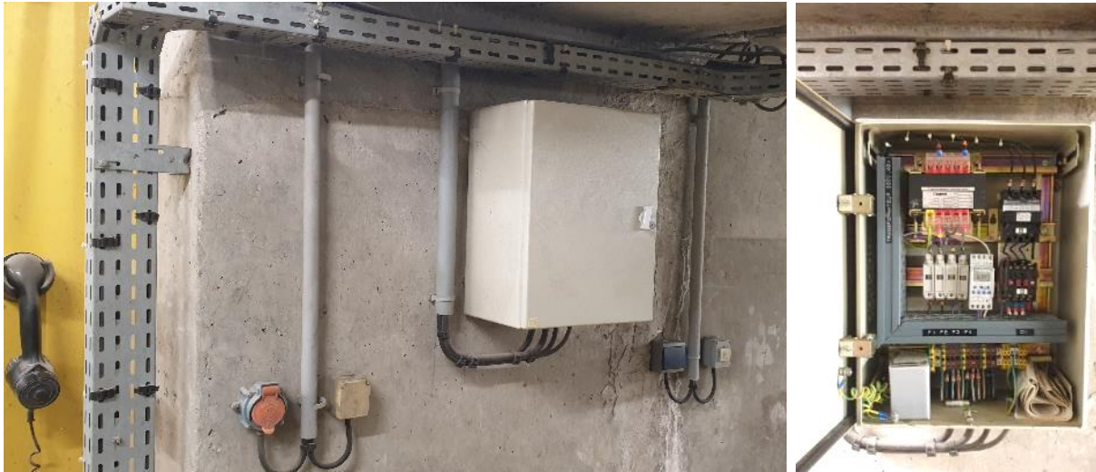
Figure 8 – Coffret de distribution électrique annexe en entrée de chambre
