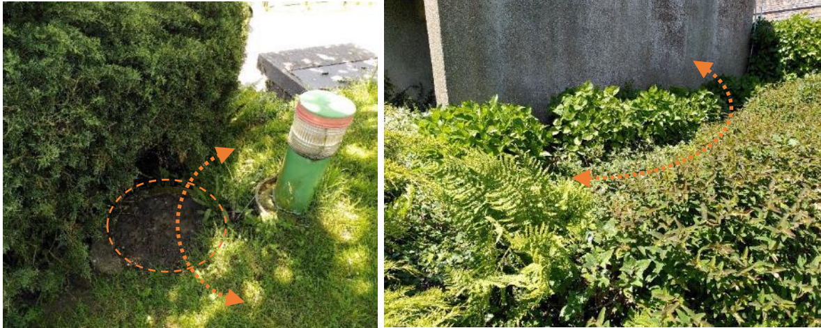
Figure 25 – départ réseaux électriques depuis la maison d'exploitation
