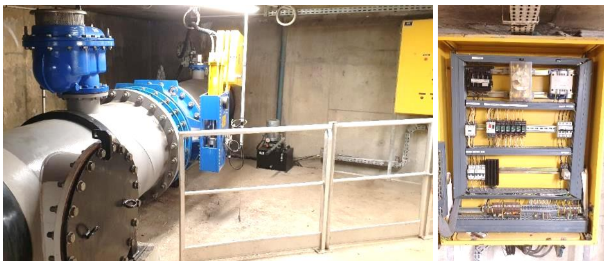
Figure 10 – Système de vanne « survitesse » sur départ DN800 et son armoire locale
