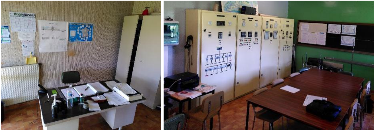
Figure 15 – Salle d’entrée (bureau) et salle technique (réunion) avec armoires électriques
