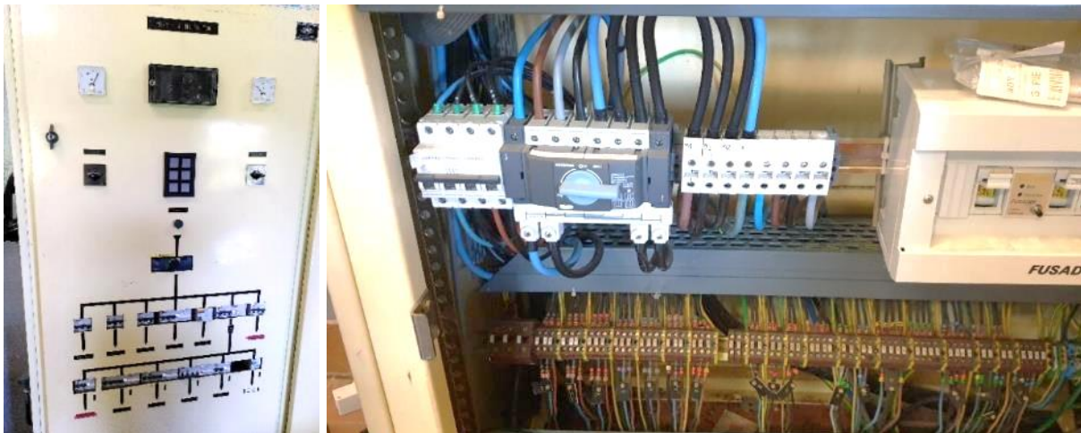
Figure 17 –Commutateur de source manuel dans le bas armoire de distribution
