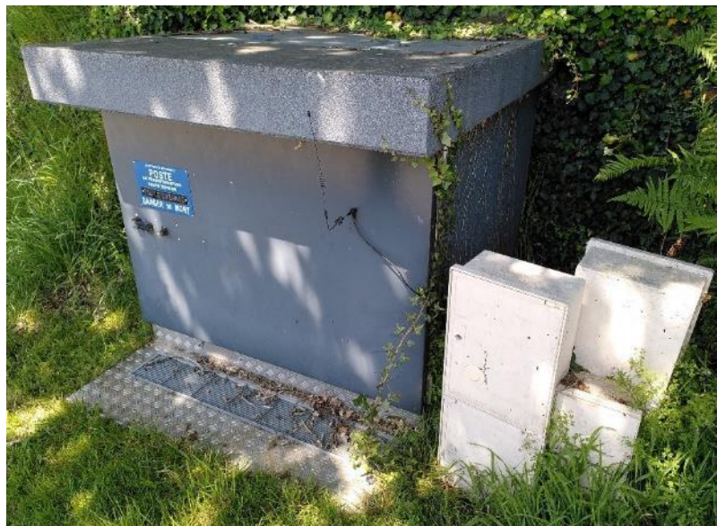
Figure 24 – transfo EDF et coffrets de distribution en limite de propriété de la maison
