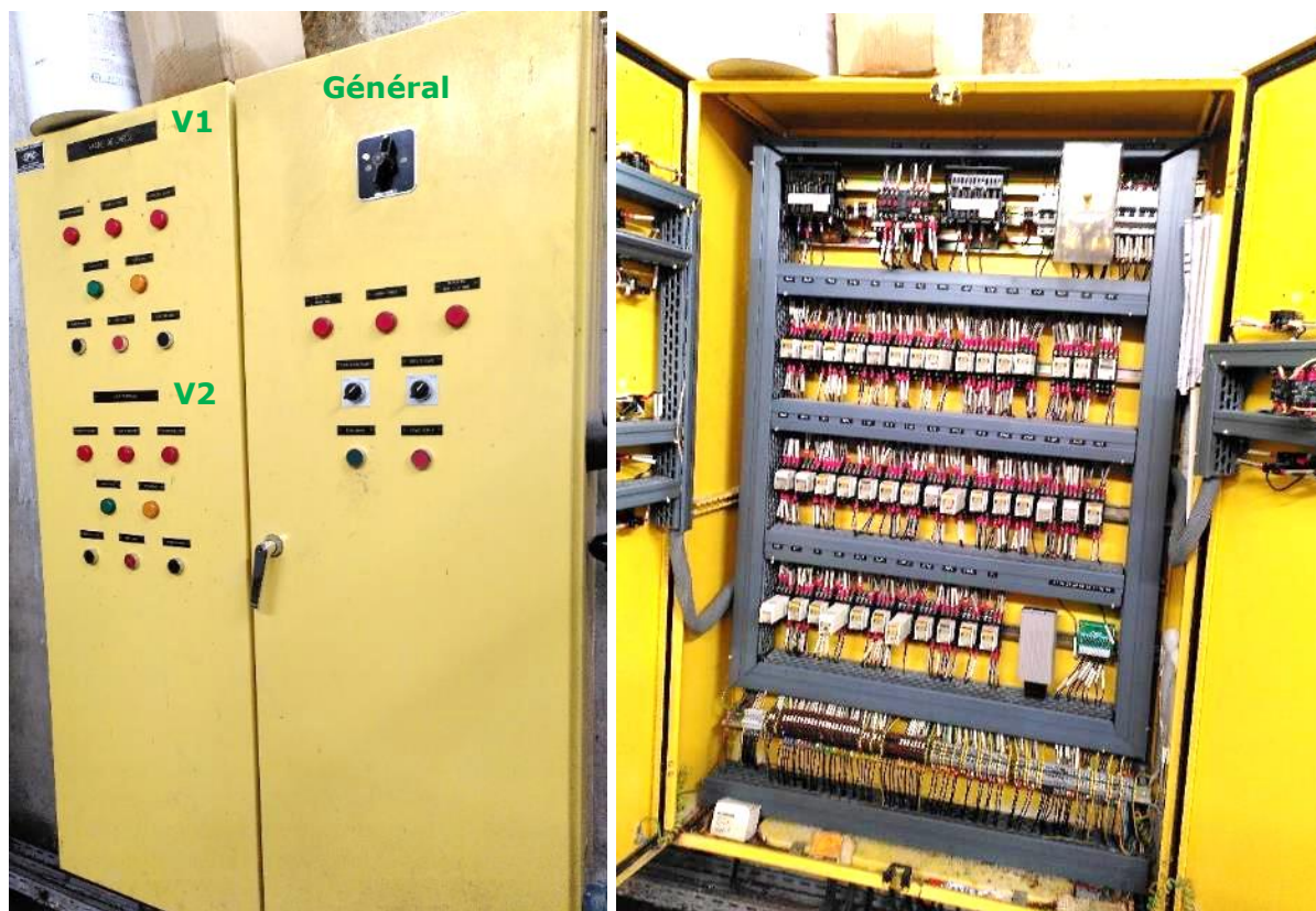
Figure 7 – Armoire de commande locale des vannes de vidange
