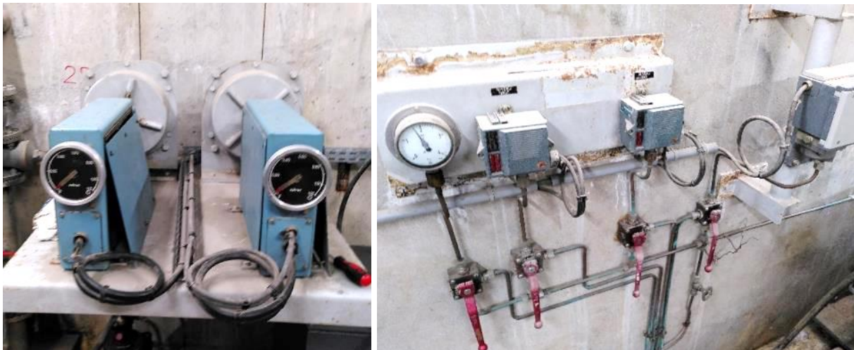
Figure 9 - Sélecteurs à came activés par câble et pressostats de mesure pression/niveau
