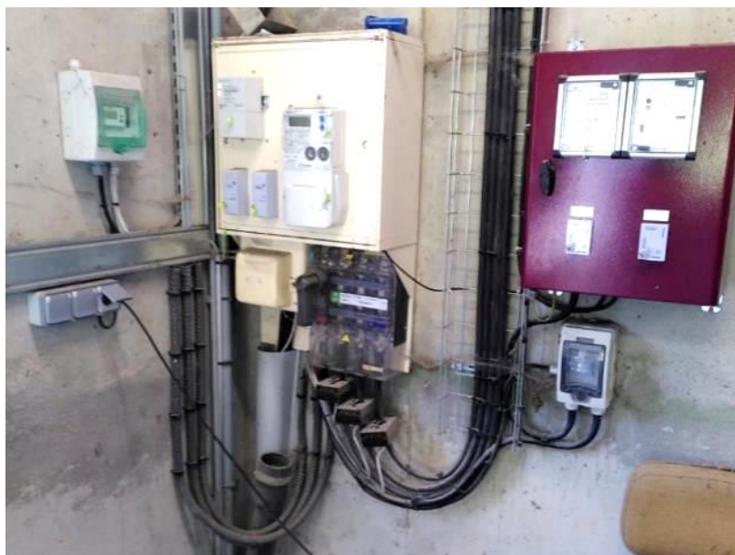
Figure 12 – Coffret d'injection de la production électrique, mur nord du local
