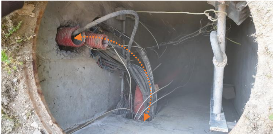
Figure 27 – Regard d'arrivée réseaux dans local d'accès galerie
