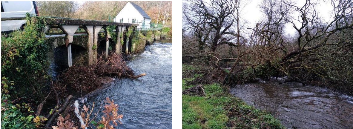
Embâcles contre un pont sur l'Elorn et arbre tombé dans la Mignonne
